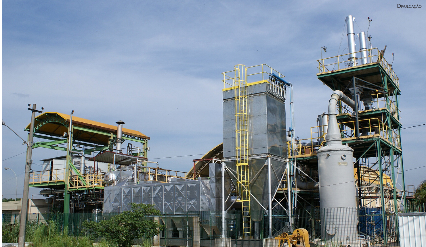
Sistema de tratamento dos gases de combustão da Usinaverde
