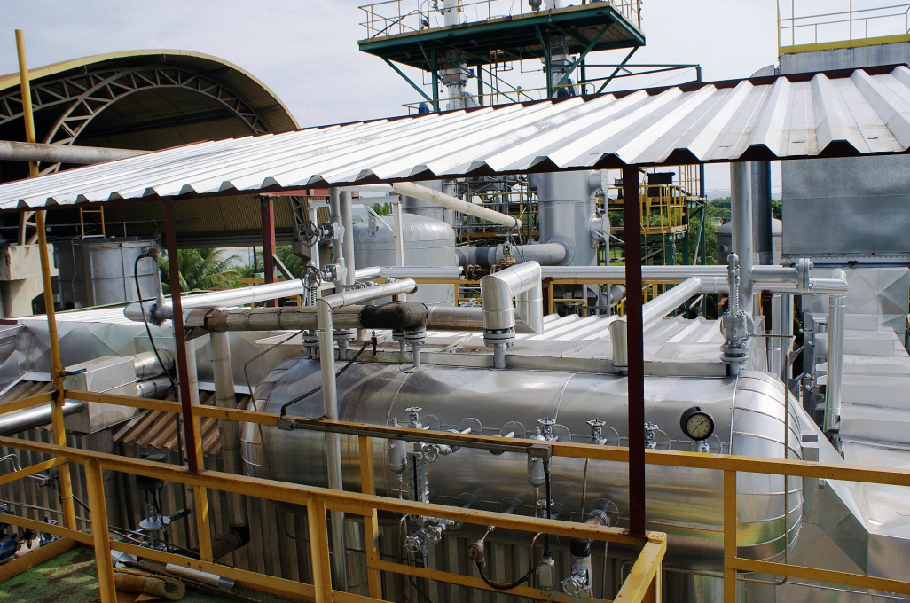
A caldeira utilizada na Usinaverde. Esse equipamento gera vapor d'água e utiliza o calor dos gases de combustão para produzir energia elétrica.
